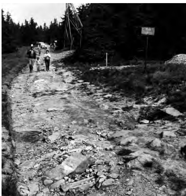
Droga na Śnieżkę na górze Růžová hora prowadzi pod kolejką linową. Jej podbudowa (czes. štět) została zniszczona przez miliony kroków, droga doczekała się remontu dopiero w latach 90. (fot. archiwum Dyrekcji Karkonoskiego Parku Narodowego)
