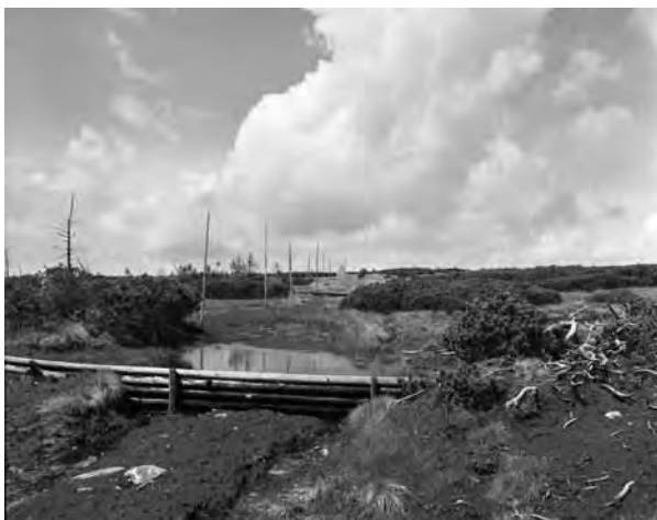
Zapory na dawnym szlaku prowadzącym od Labskiej do Voseckiej boudy chronią przed erozją powodowaną przez udeptywanie podmokłego terenu i przyczyniają się do stabilności Torfowiska Panczawskiego. (zdjęcie z 1995 r., fot. Karel Hník)
