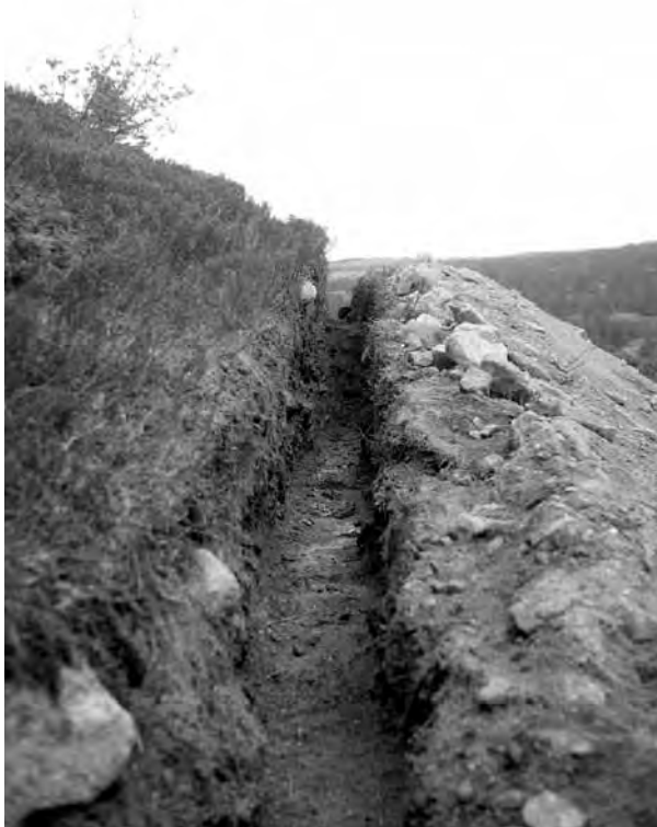
Nieprawidłowa trasa wykopu odpływu ze zbiornika biologicznej oczyszczalni ścieków z nowego schroniska Labská bouda prowadziła bezpośrednio do objętego ścisłą ochroną kotła Navorské jámy. Na szczęście zauważono błąd w samą porę i teren udało się uratować. (fot. Jan Štursa)
