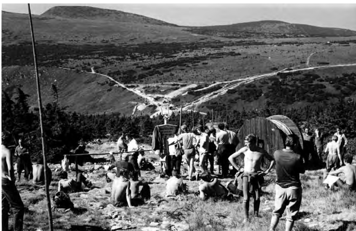
Układanie kabli energetycznych prowadzących ze schroniska Labská bouda do schroniska Martinovka i do Śnieżnych Kotłów, około 1969 r. Podobnie jak na Śnieżkę doprowadzono prąd i wodę z Polski, to na Śnieżne Kotły doprowadzono prąd z Czech. Systematyczna budowa infrastruktury energetycznej w Karkonoszach trwa od 1965 r. do dnia dzisiejszego. W tym okresie nie tylko wymieniono linie zewnętrzne, ale także konsekwentnie doprowadzono prąd do prawie wszystkich dotychczas nie posiadających go miejsc (z większych enklaw np. Klínové Boudy w 2008 r.). Do tego należy jeszcze dodać przewody informatyczne. Budowa instalacji liniowych jest bardzo delikatną sprawą, do dnia dzisiejszego skrupulatnie śledzoną. (fot. Miroslav Hladík).
