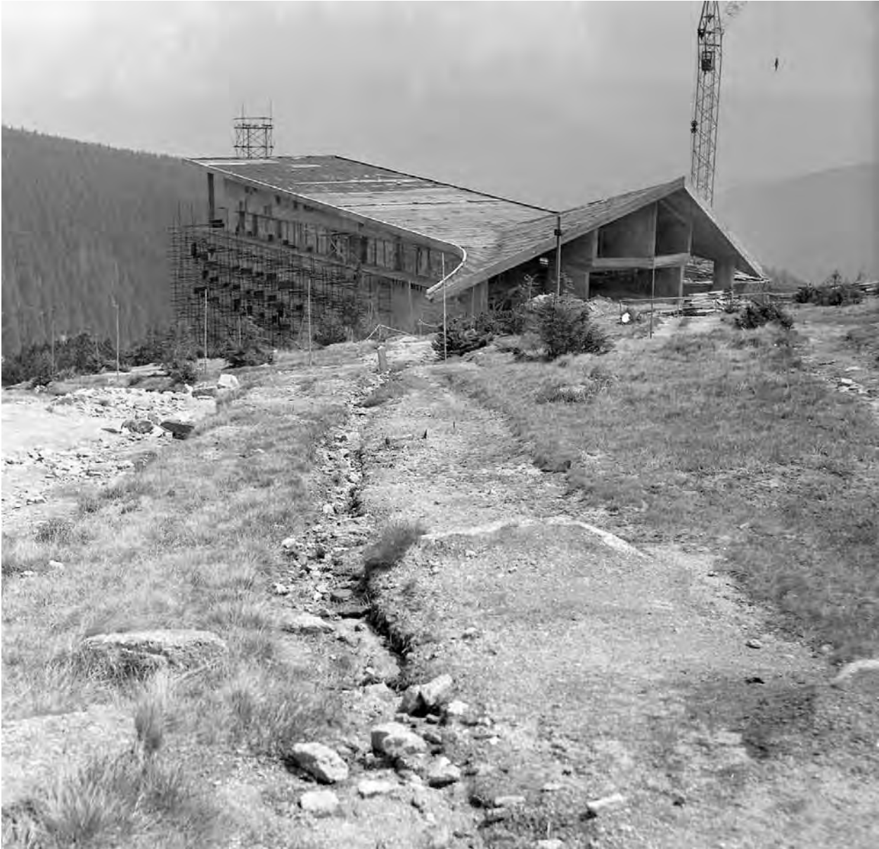
Uszkodzenie terenu w miejscu przebiegu wodociągu do nowego schroniska Labská bouda. (fot. Jan Štursa)
