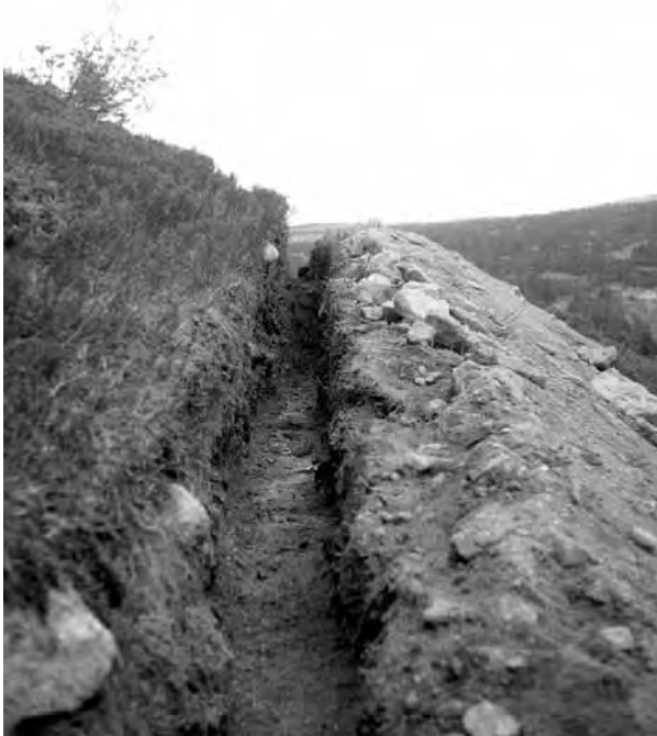
Der falsch verlegte Abfluss aus der biologischen Faulgrube der neuen Labská bouda führte direkt in die streng geschützte Navorská jáma. Dieser Irrtum wurde glücklicherweise rechtzeitig erkannt und das Gelände assaniert (Foto Jan Štursa)
