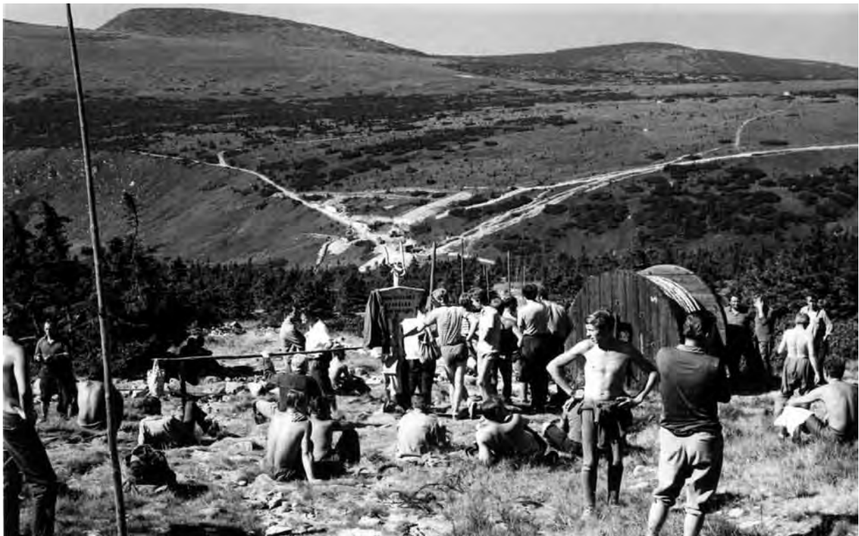
Kabelverlegung von der Labská bouda (Elbfallbaude) zur Martinovka (Martinsbaude) und zu den Schnee gruben, ca. 1969. Ähnlich wie zur Schneekoppe führen Kabel und Wasserleitung auf polnischer Seite hinauf, zu den Schnee gruben wiederum ein Kabel aus Tschechien. Die konsequente Verkabelung des Riesengebirges dauert von 1965 bis heute an. In dieser Zeit wurde nicht nur die Oberleitungen ersetzt, sondern auch nahezu sämtliche bisher nicht angeschlossenen Orte (von den großen Enklaven z.B. auch die Keilbauden) konsequent elektrifiziert. Dazu kommen noch die Linien der Fernsprechkabel. Linienbauten sind immer eine heikle Sache, deshalb werden sie mit Argusaugen überwacht (Foto Miroslav Hladík)
