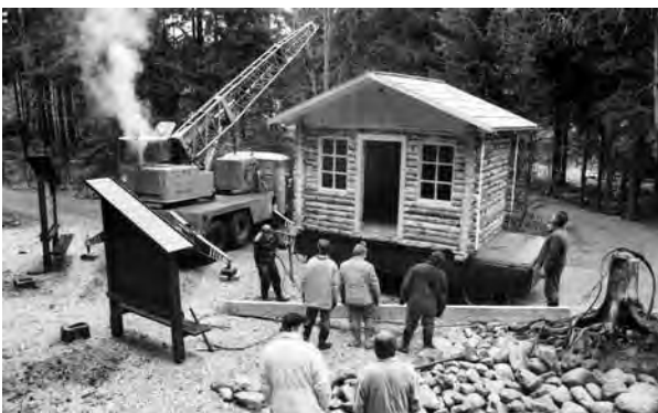
Installation der Blockhütte des Geländedienstes vor Dívčí lávky (Mädelsteig) im Oktober 1994. Im Sommer sollte sie als Informationsstelle dienen, im Winter wiederum zur Unterstützung der Skiläufer auf der ‚Trimm-dich-Loipe‘. Ringsherum stehen Tafeln mit aufschlussreichen Texten, rechts das präparierte Wurzelwerk eines Fichtenstumpfs (Foto Karel Hník)
