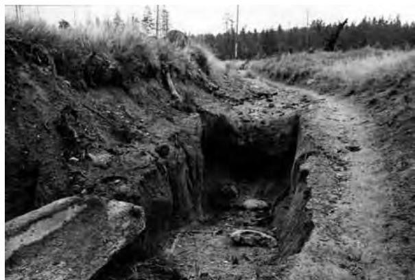
Auch so sahen erosionsgeschädigte Wege aus. (Foto Fotoarchiv der KRNP-Verwaltung)
