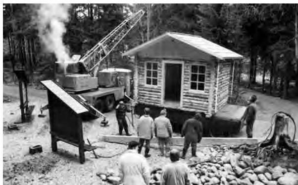
Instalace srubu terénní služby k Dívčím lávkám v říjnu 1994. V létě srub měl sloužit pro podávání informací, v zimě jako zázemí pro uživatele běžecké stopy Buď fit! Okolo jsou panely s naučnými texty, vpravo vypreparované kořánky smrkového pařezu (foto Karel Hník)
