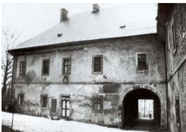
Stav objektu v roce 1993 ... Stan obiektu w 1993 roku... Its state in 1993 ... Zustand des Objektes im Jahre 1993 ...
