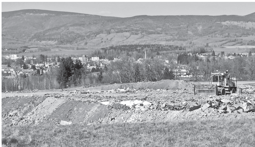
Obr. 1. Skládka komunálního odpadu v Dolní Branné (foto D. Vodnárek).
